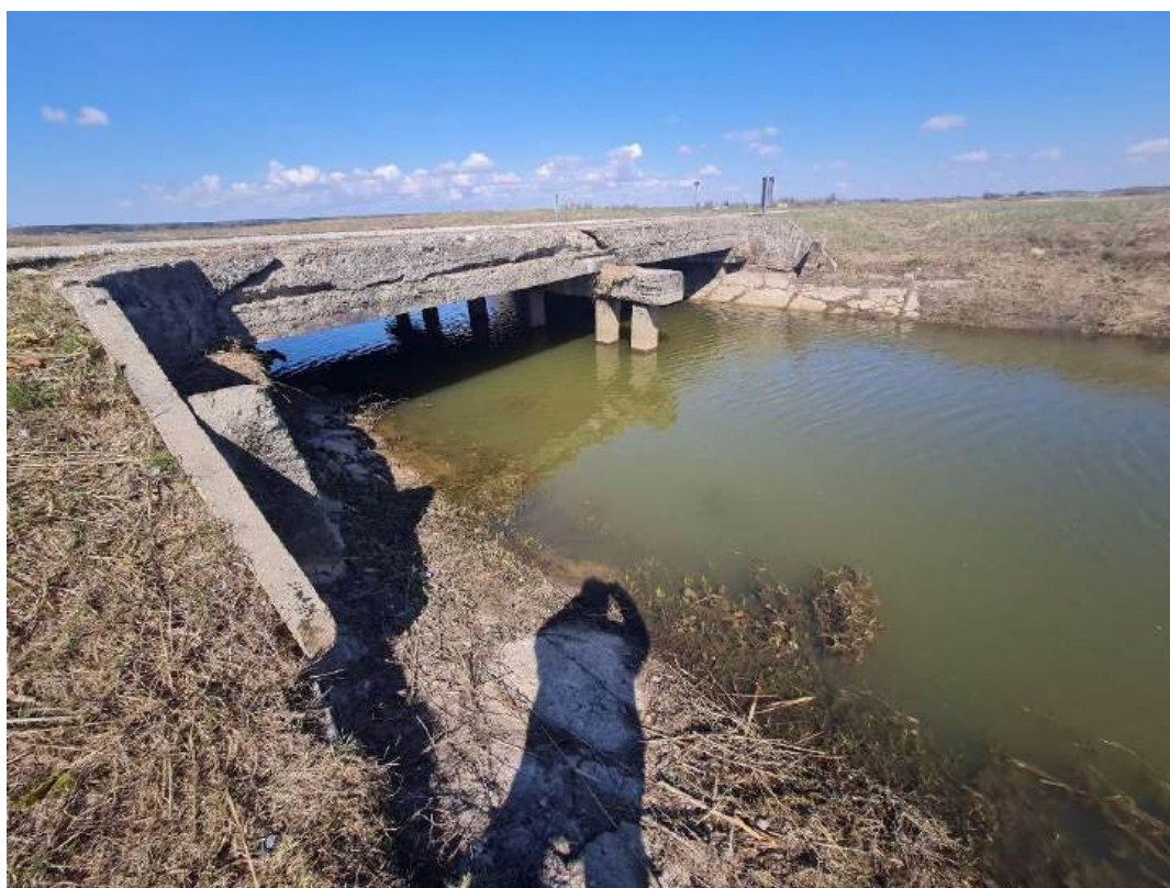
Pav. 5 Tilto fasadas ir defektai (betono įtrūkimai, armatūros korozija, suirę vagos šlaitų tvirtinimai)
